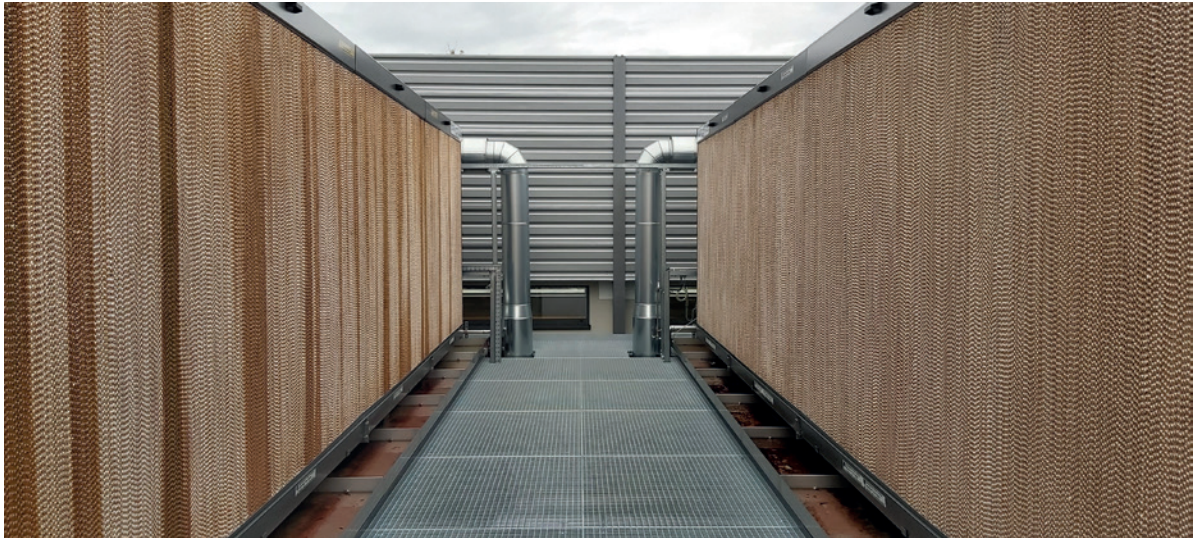
Abb. 5.7: Rückkühler mit optionaler „adiabater“ Vorkühlung. Die sichtbaren Filtermatten werden bei Bedarf mit Wasser benetzt.
