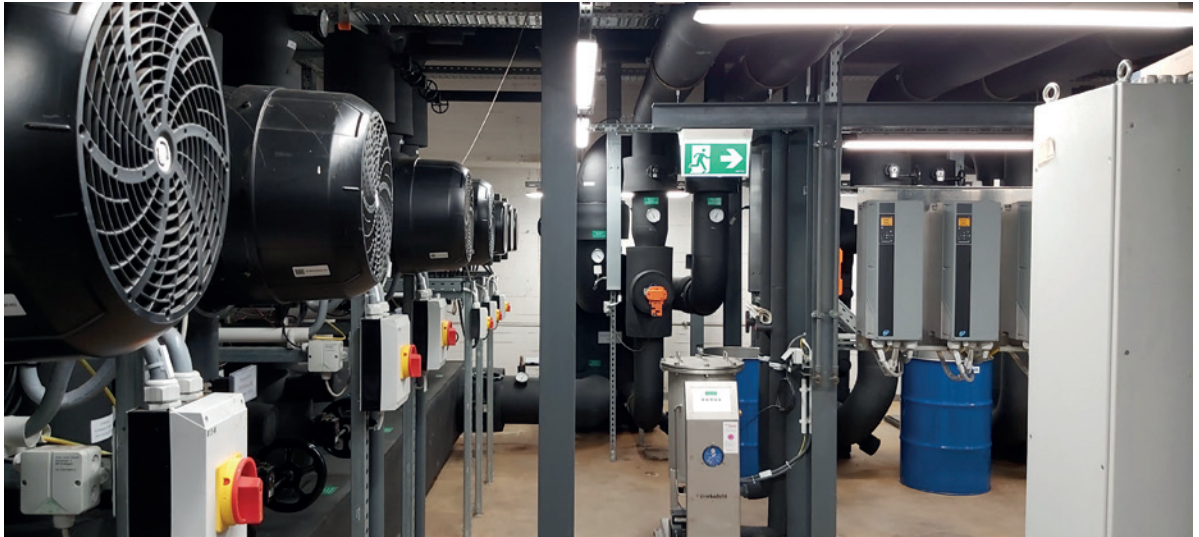
Abb. 5.10: Infrastruktur-Ertüchtigung: Pumpenanlage des neuen Warmwasser-Kreislaufes.
